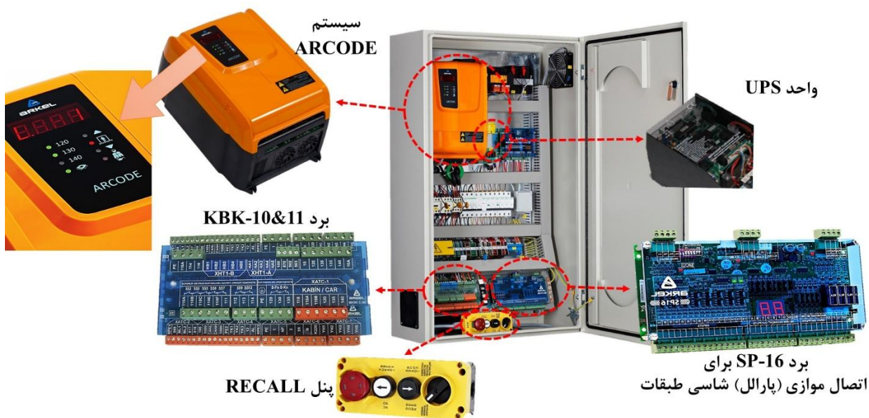
شکل ۴. نمای کلی تابلو فرمان
