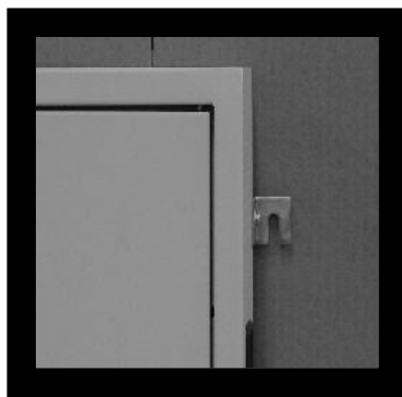
شکل ۳. اتصالات تابلو فرمان
